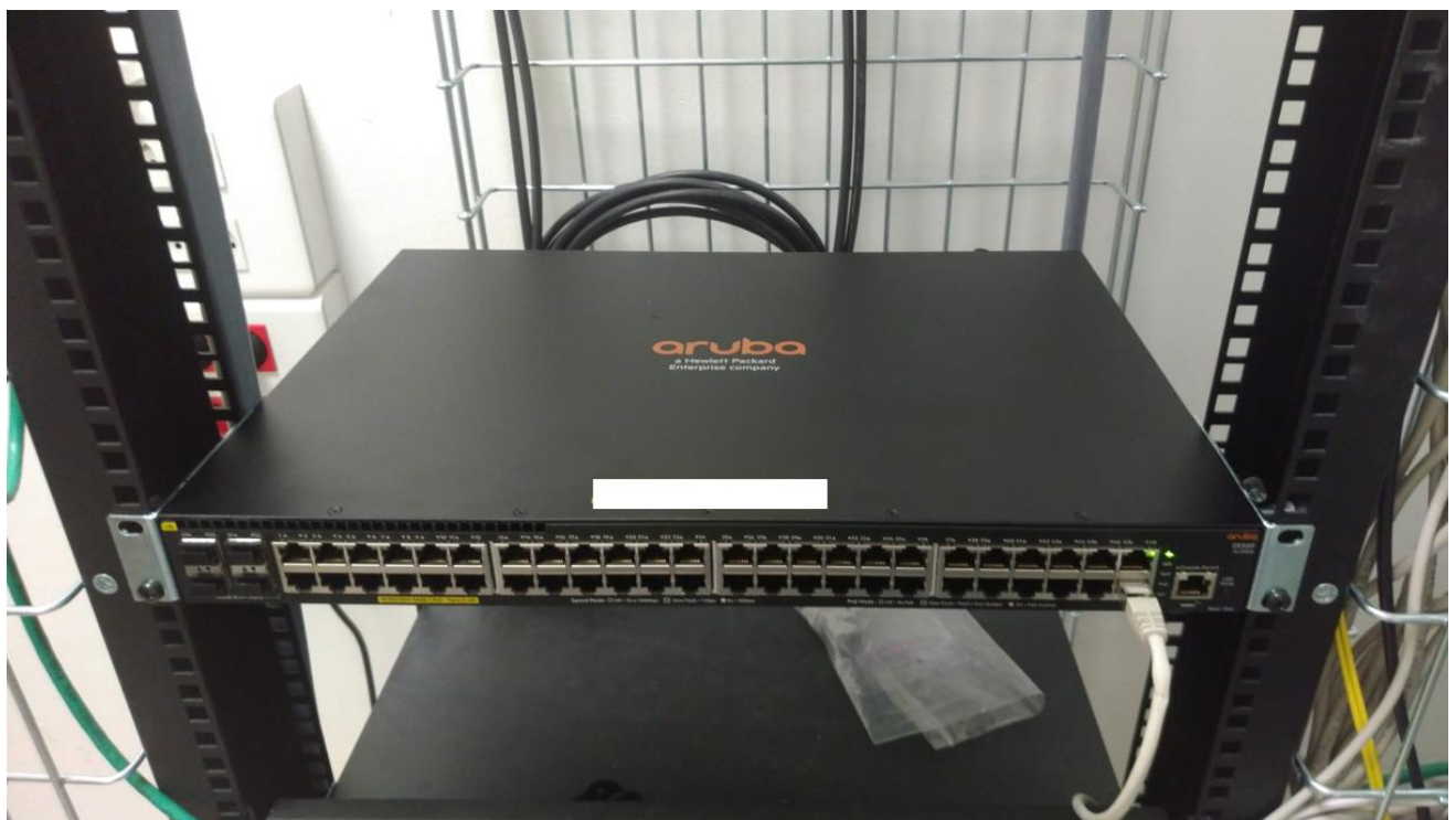
Figure 5: Un switch 2930F configuré et installé
